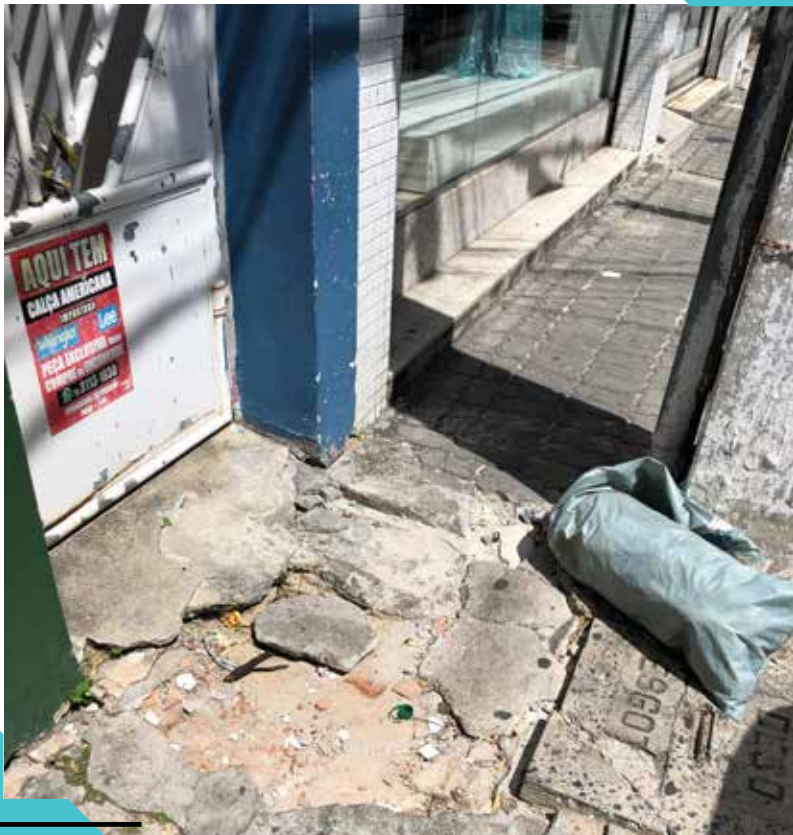
Fotografia de calçada com desníveis e entulho
